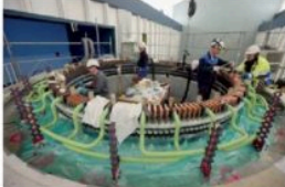
Le photographe libanais Houssein Shaaban photographie des travailleurs à l'usine hydroélectrique de Hordax. HOUSSEIN SHAABAN
