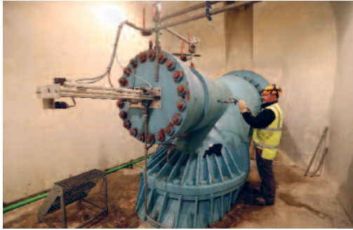
Conduites d'eau Grande Dixence
